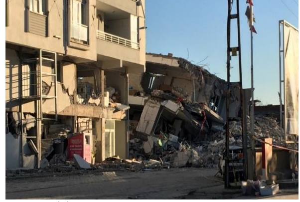
Şekil 13.(b). Türkoğlu ilçesi deprem sonrası oluşan hasarlar (Fotoğraf: Koçkar, 2023)
