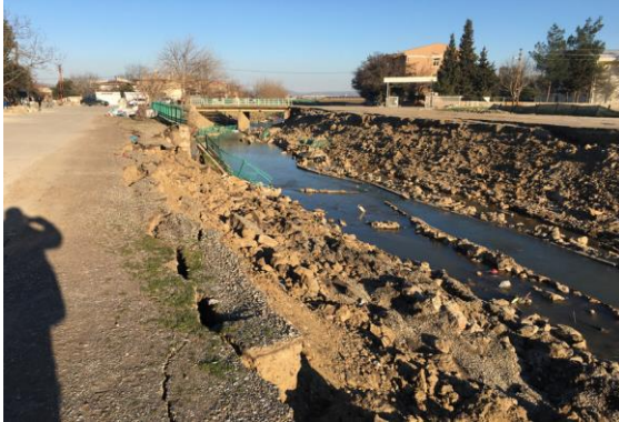
Şekil 10.(a). Türkoğlu ilçe merkezi içerden geçen kanalda meydana gelen oturmalar ve yanıl yayılmalar
