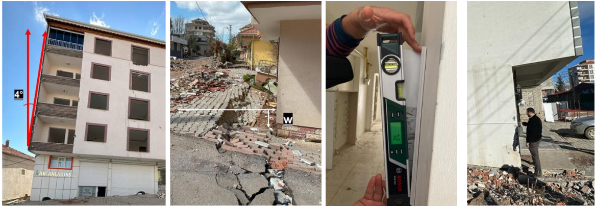
Şekil 2. Binaların geometrik özelliklerinin ve hasar seviyelerinin incelenmesi
