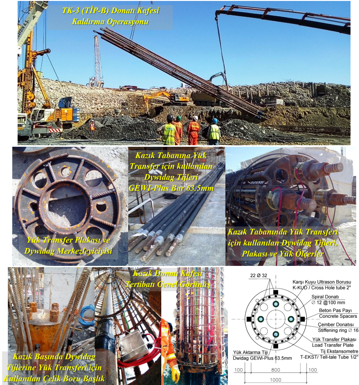
Şekil 4. Enstrümente edilmiş TK-3 deney kazığı (TIP-B) donatı kafesi genel ve detay görünüşü.
