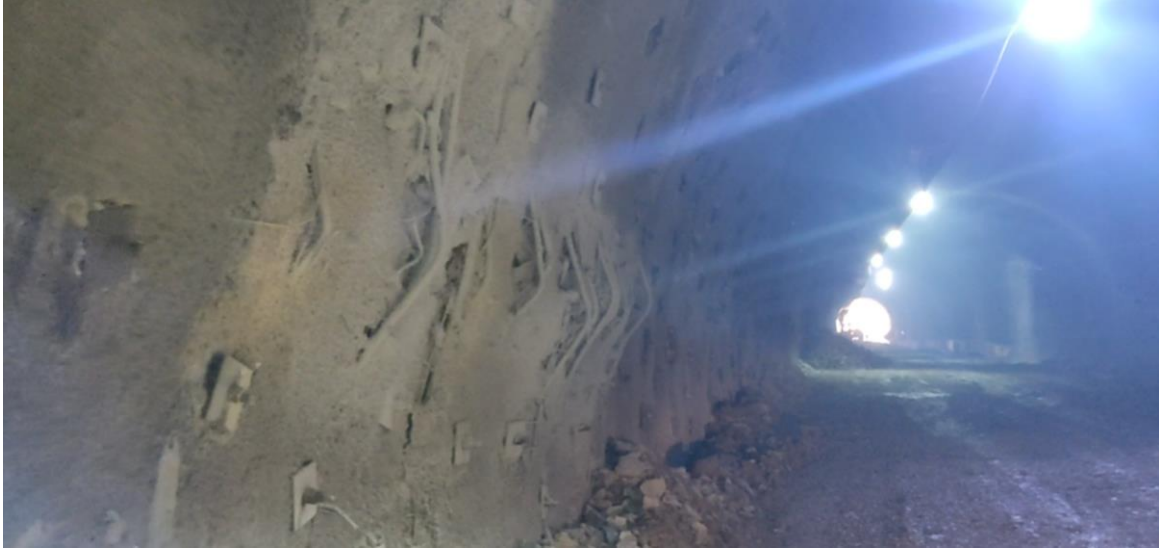
Şekil 1. Sağ tüp sol duvarda iksada gözlenen burkulmalar
