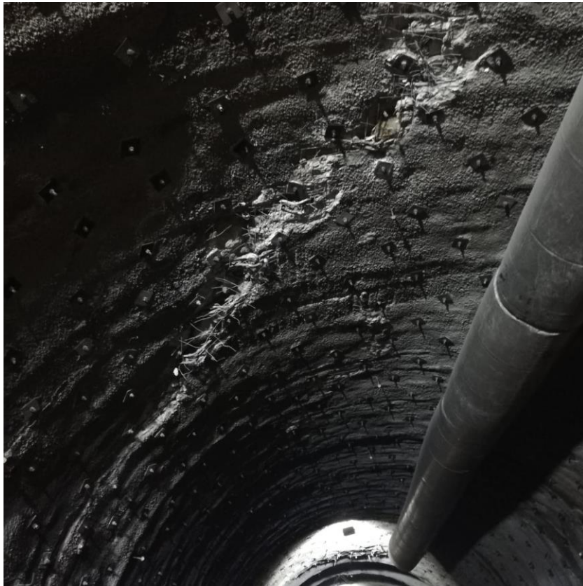
Şekil 2. Sağ tüp tavanda ve sağ omuzda tespit edilen aksenal ve vev yönlü çatlaklar
