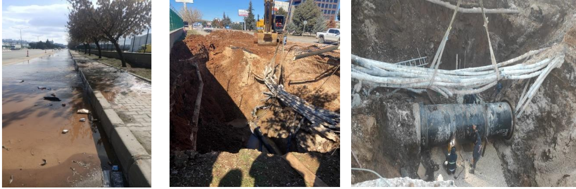
Şekil 2. Kartalkaya öngermeli beton hattında meydana gelen problem ve hattaki tamir işlemleri
